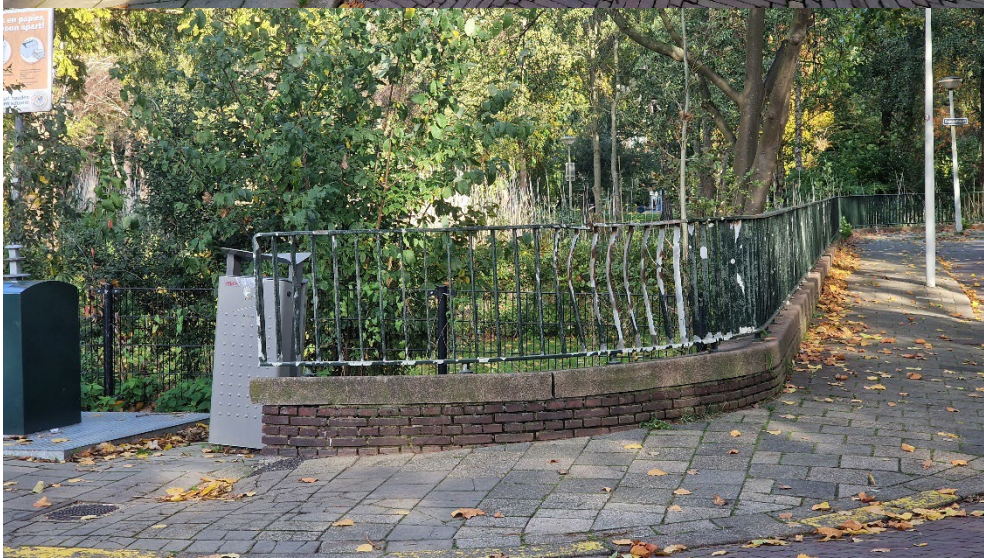
Hekwerk hoek Granaathorst met Robijnhorst beschadigd.
