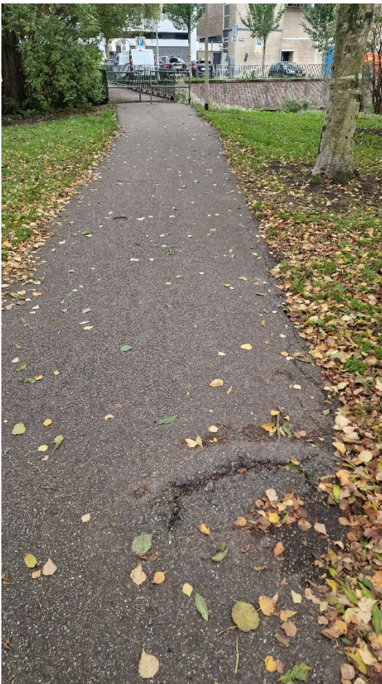
Asfalt voetpad door wortelopdruk beschadigd. Voetgangers kunnen nu struikelen. Gaarne spoedig herstellen.
